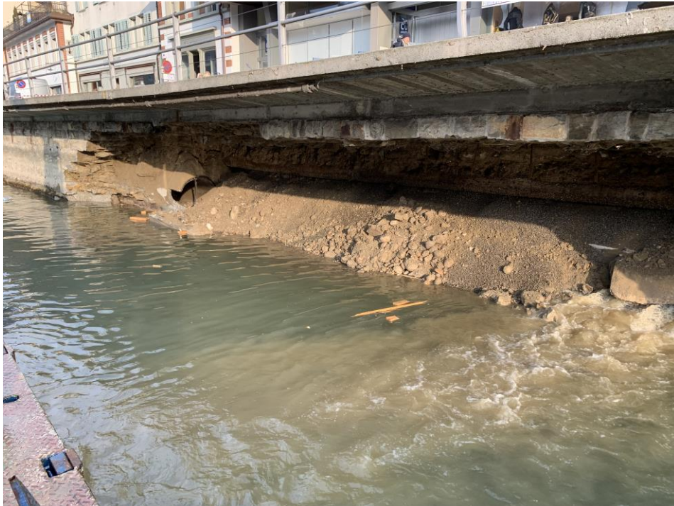
Bild 2: Die hinter der Mauer verlaufende Abwasserleitung von REAL wurde durch das Abrutschen der Ufermauer beschädigt und teilweise abgebrochen.
